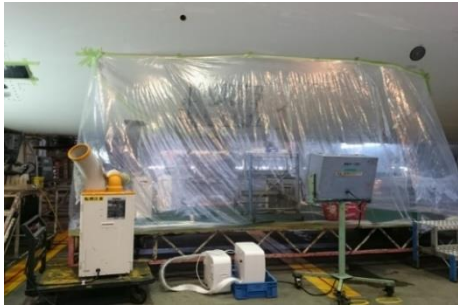
炭素繊維層にほこり、水分が浸入することを防ぐため、クリーンルーム内で複合素材機材の整備作業を実施する様子
